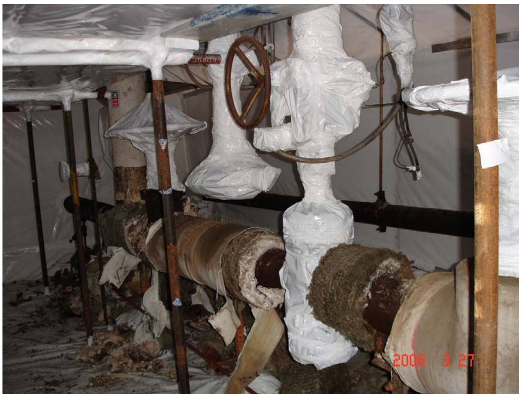
Foto n° 4 – Coibentazione di tubazioni presso la Centrale Termoelettrica Enel del Mercure (Fonte ASP – Distretto di Castrovillari)
